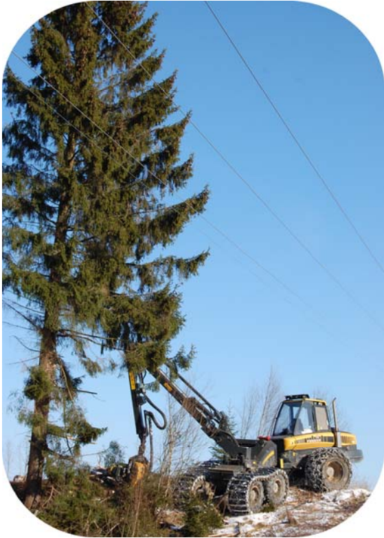
Sikringshogst av utsatt grantre, regionalnett
